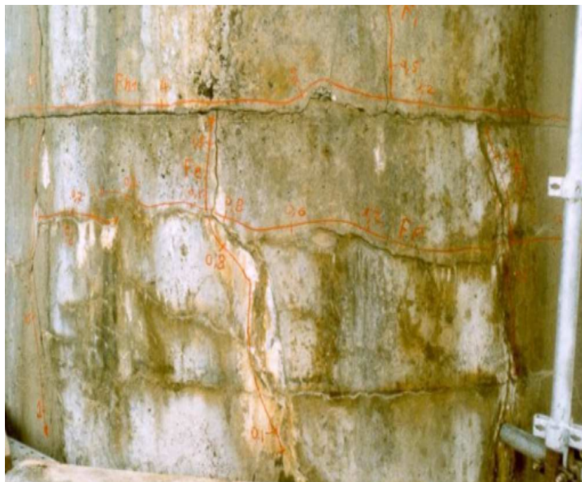
FIGURE 2 – Conséquences mécaniques de béton atteint de réaction sulfatique interne (Bulletin des Laboratoires des Ponts et Chaussées) [10]
